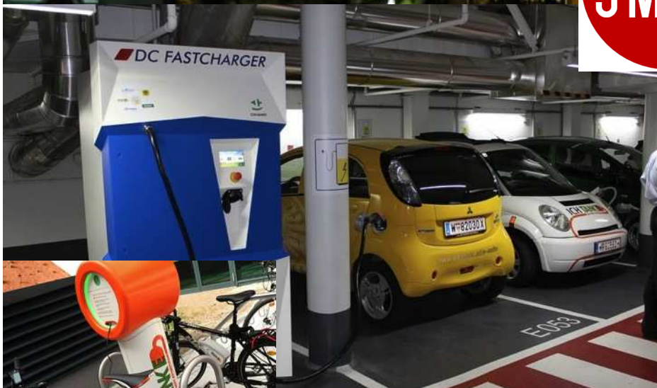
E-Ladeinfrastruktur in Parkgaragen
